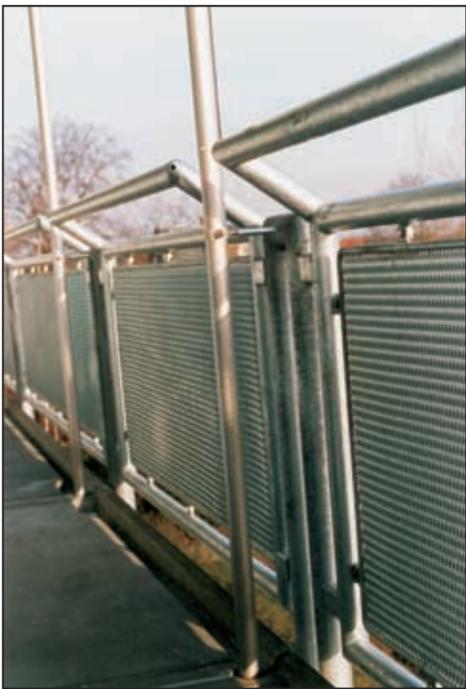
Varmforzinkede altanrækværker i højhusbyggeri.
