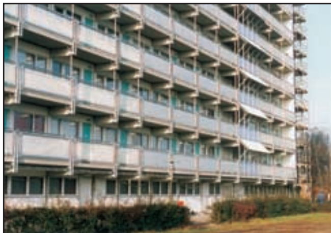
Varmforzinkede altanrækværker i højhusbyggeri.
