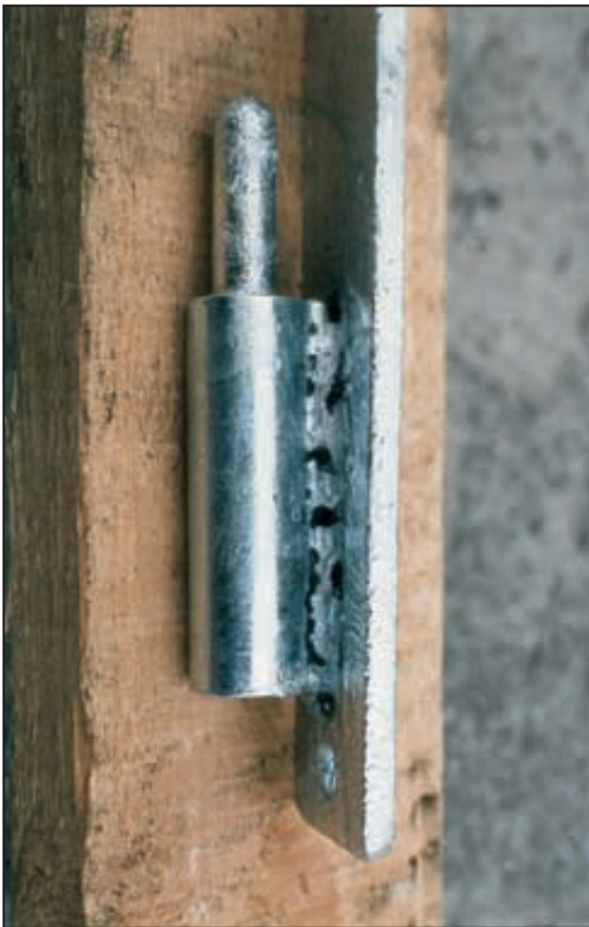
En hyppigt forekommende fejl på varmforzinkede emner. Mangelfuld afrensning af svejse­slagge før varmforzinkning.
